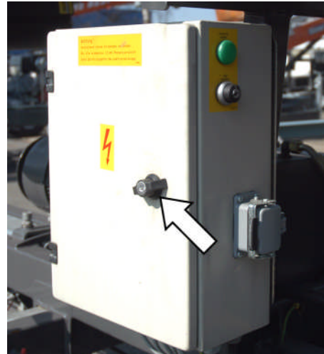
Fig. 288: Armoire de commande
