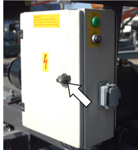
Fig. 295: Armoire de commande
