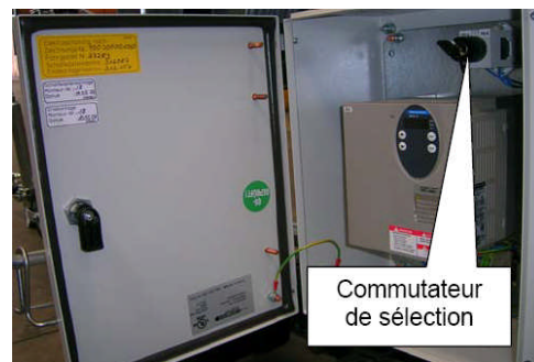
Abb. 131: coffret de commande
